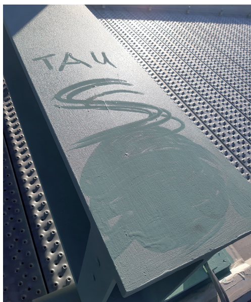
Bild 2 Betaute Oberfläche einer Umspannanlage
